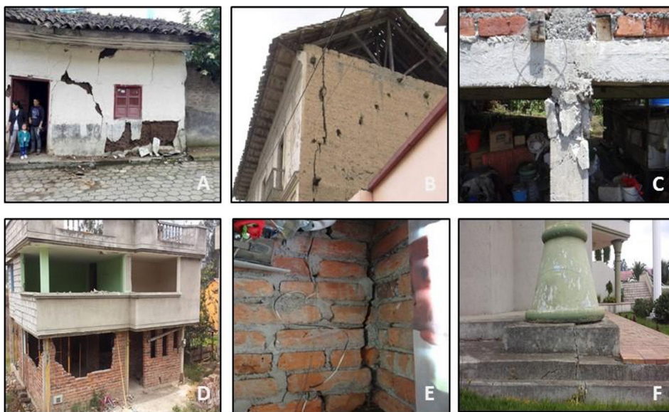
Figura 4. Daño en elementos estructurales
