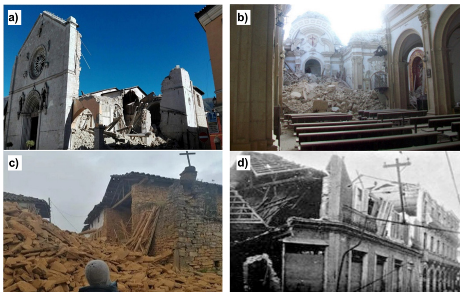
Figura 1. Edificaciones destinadas a usos religiosos dañadas durante la ocurrencia de sismos fuertes ocurridos Italia, España, Perú y Cuba
