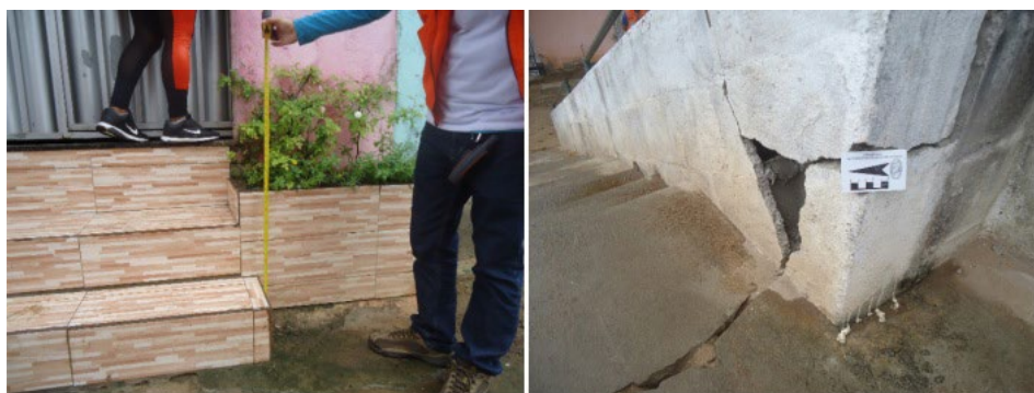
Figura 8. Calçada em casa próxima ao Canal do Baldo, no Complexo do Passo da Pátria (imagem a esquerda). E rachaduras na estrutura do Canal do Baldo no Complexo do Passo da Pátria (imagem a direita)
